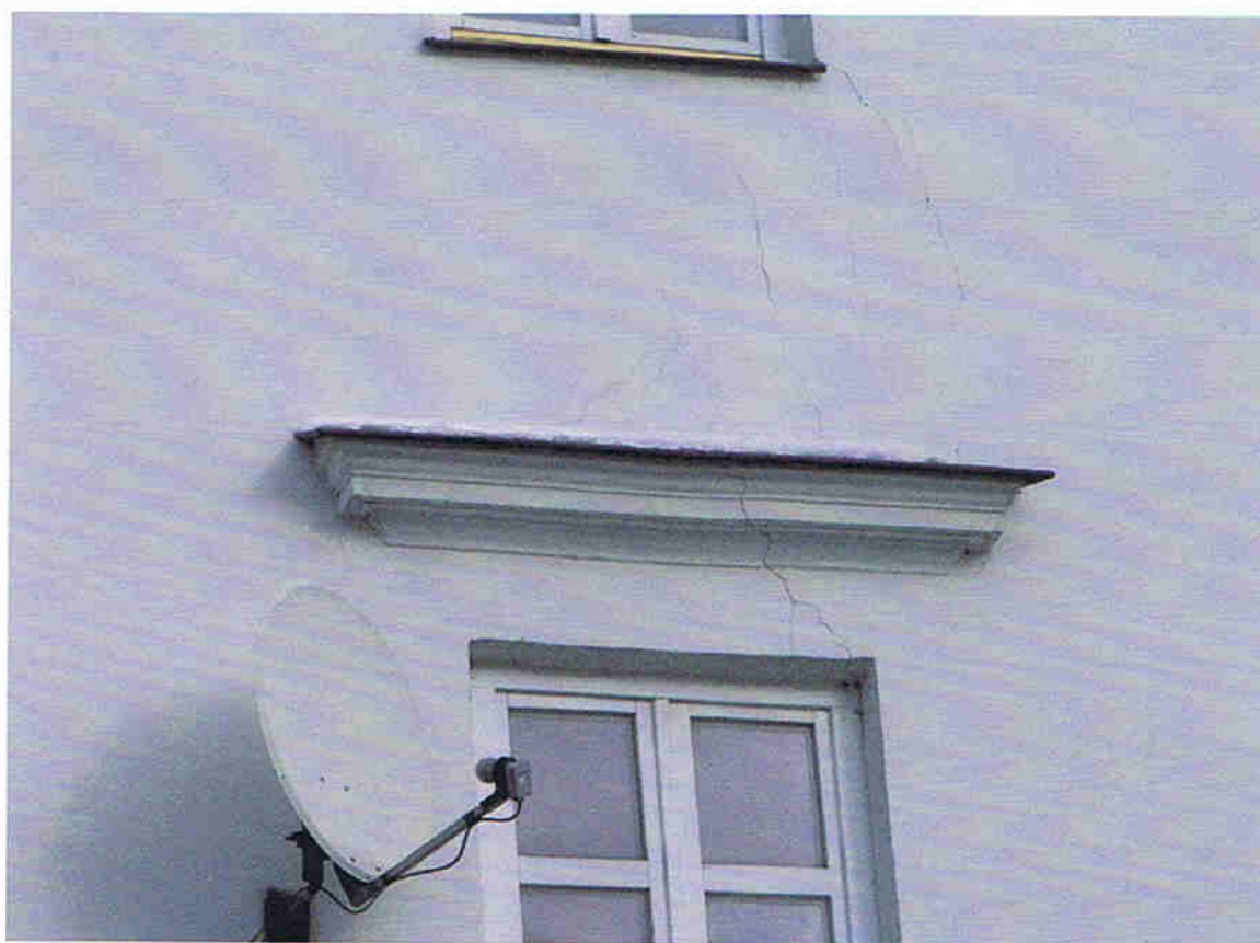
Fot. 11 Spękania ściany frontowej
