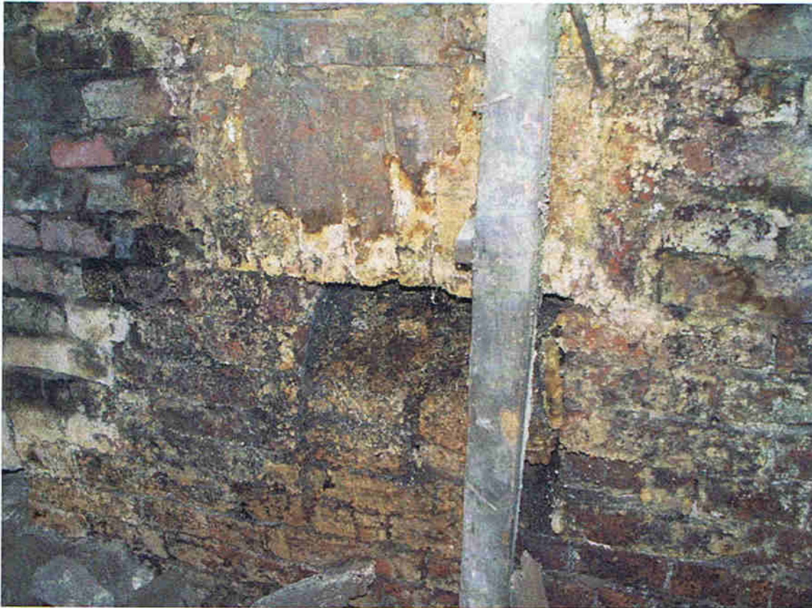
Fot. 18 Naloty na ścianie piwnic
