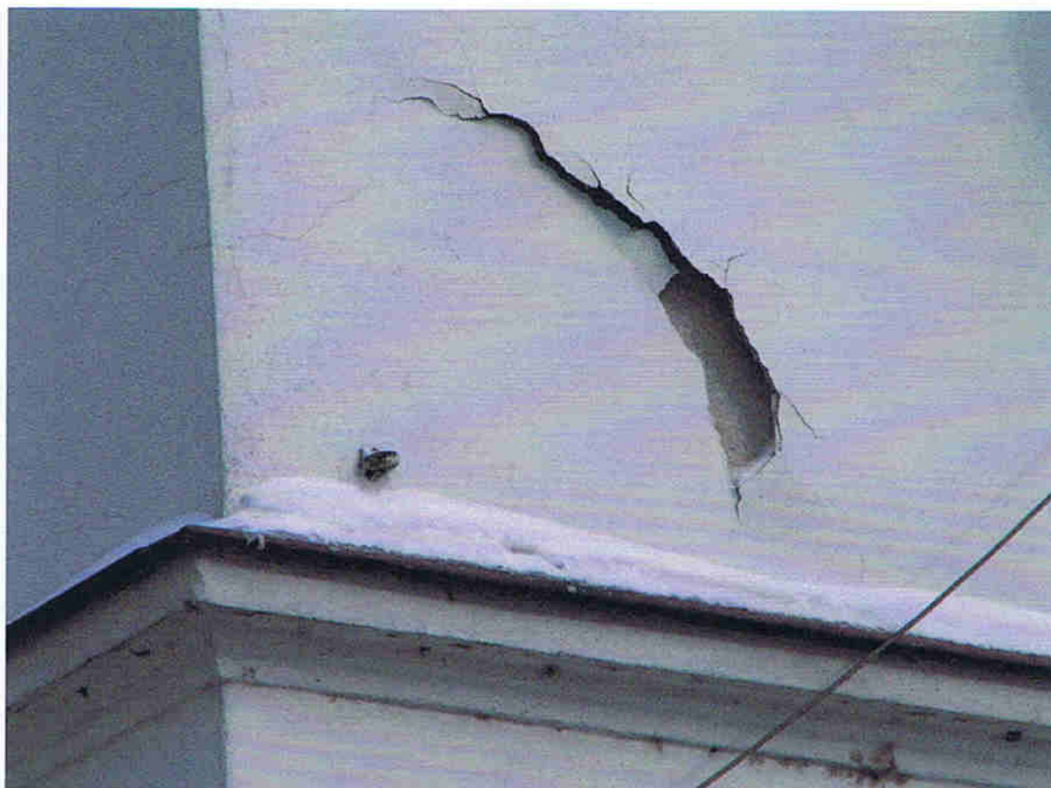
Fot. 10 Odspojenie tynku na ścianie frontowej
