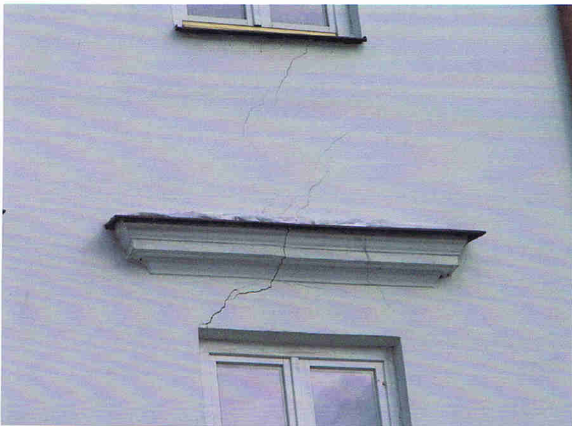
Fot. 13 Spękania ściany frontowej
