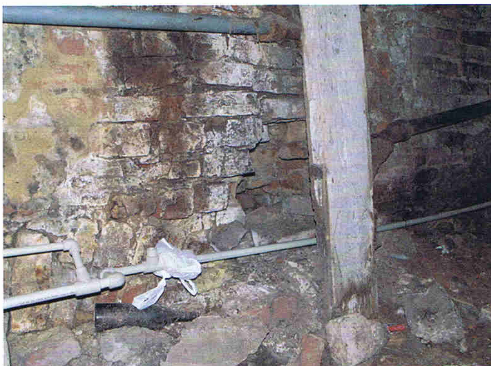
Fot. 17 Uszkodzenia ściany piwnicznej spowodowane montażem instalacji
