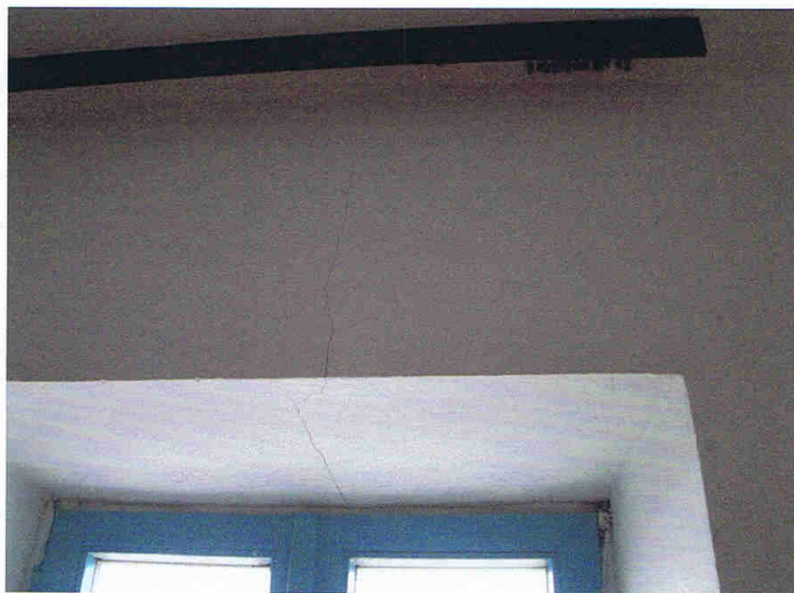
Fot. 9 Uszkodzone nadproże okienne
