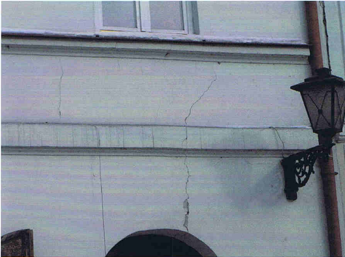
Fot. 12 Spękania ściany frontowej
