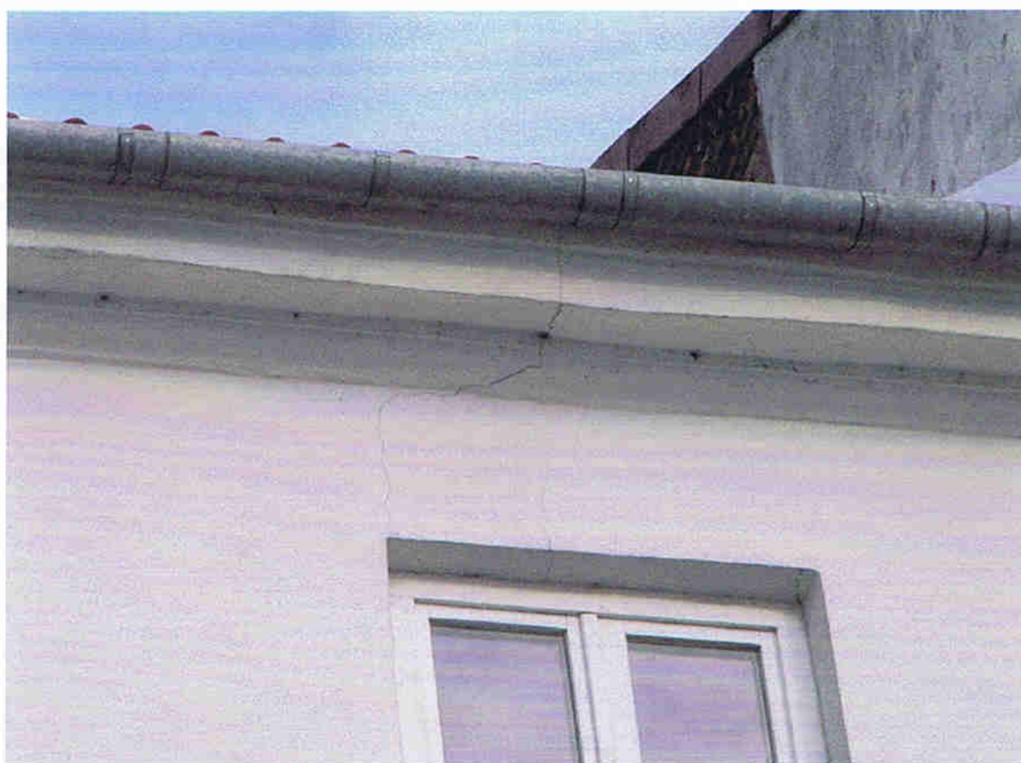
Fot. 5 Uszkodzony gzyms od ulicy Grodzkiej
