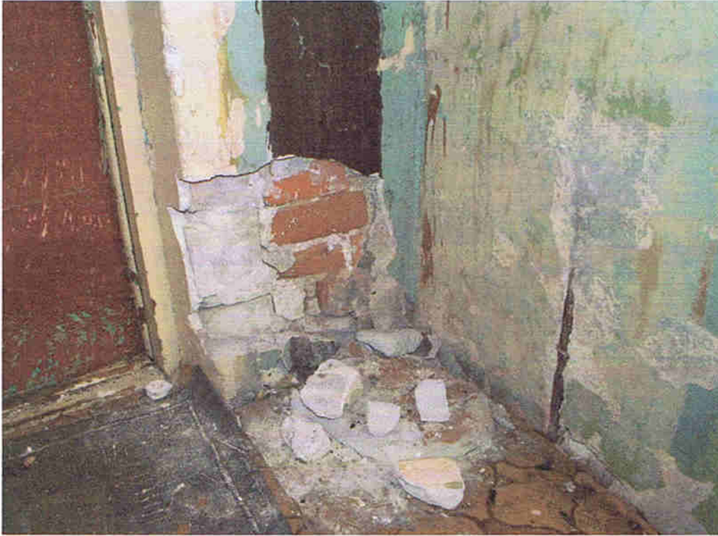
Fot. 14 Uszkodzenia ściany wewnętrznej
