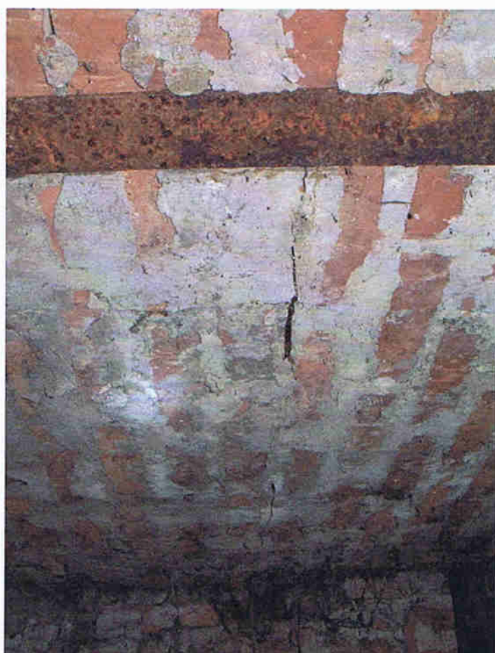
Fot. 7 Uszkodzona płyta stropu nad piwnicą
